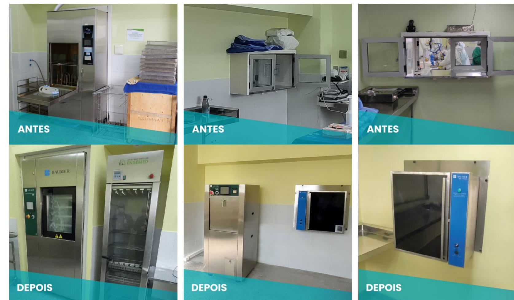
Modernização CME Fonte: GAD HU-FURG
