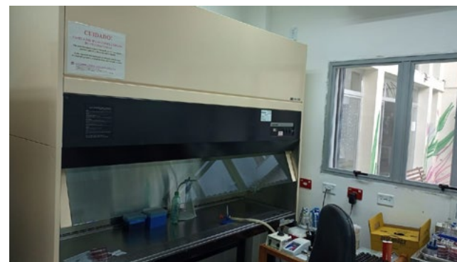
Sistema de Exaustão e Cabine de segurança Biológica - Fonte: GAS HU-FURG
