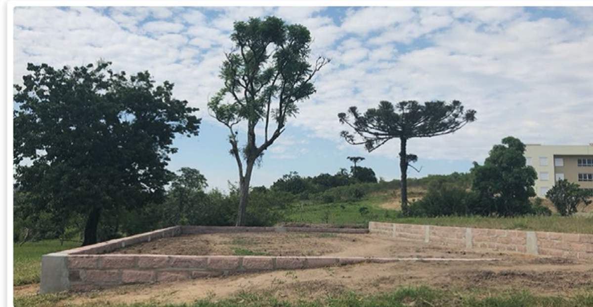
Início da construção das quadras de vôlei de areia e futebol na Unidade Bom Princípio.
